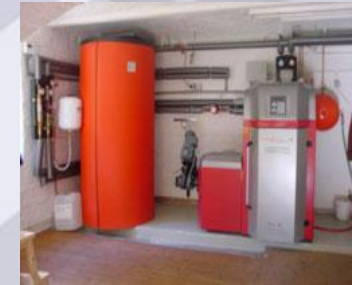
nachträgliche Einbauten z.B. Zentralheizung
